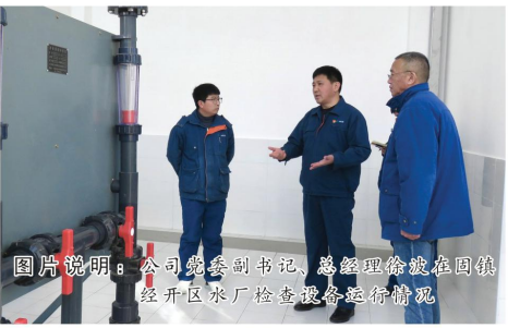
图片说明：公司管线所副书记、总经理徐波在固镇经开区水厂检查设备运行情况
